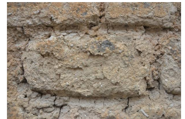
Effritement de maçonnerie
